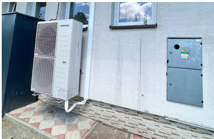
Tribúna - na základe žiadosti TJ Novoť so spolufinancovaním SFZ vo výške asi 40 percent bolo vybudované vykurovanie v budove futbalovej tribúny prostredníctvom tepelného čerpadla.
